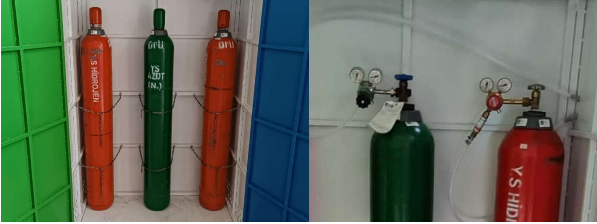
Şekil 2: Hidrojen ve azot tüpleri ve çift kademe basınç regülatörleri.
